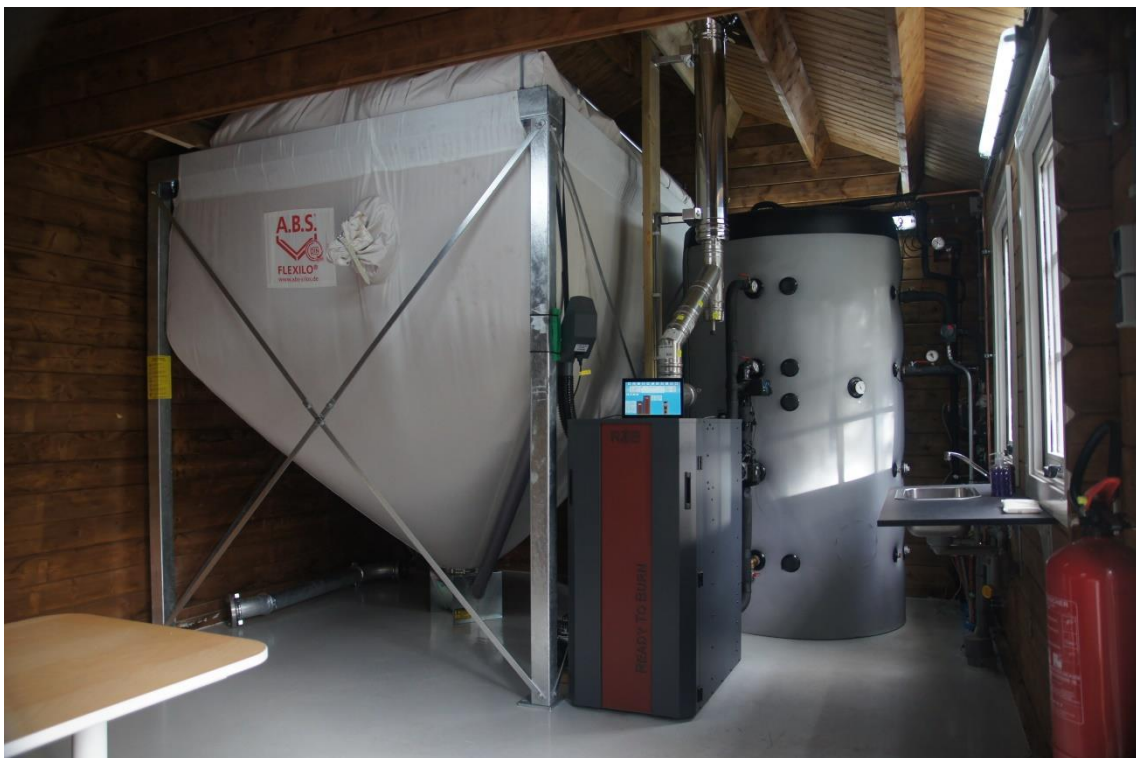
Figuur 2.9 Voorbeeld van een pelletgestookte ketel met zaksilo en warmtebuffer ter verwarming van een woonhuis (NBE RTB16)
